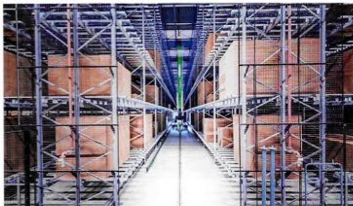
▲ Im neuen Hochregallager 4 der Liebensteiner Kartonagen werden die Wellpappen-Formatstapel mit unterschiedlichsten Abmessungen zwischengelagert (Fotos: Hörmann Logistik)
