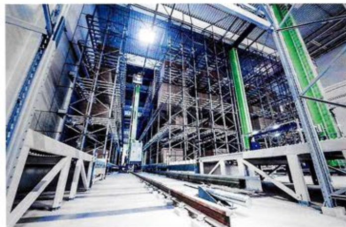
▲ Die Steuerung und Verwaltung der kompletten Liebensteiner Lagertechnik erfolgt durch das Hörmann Intra Logistics System Hi LIS
