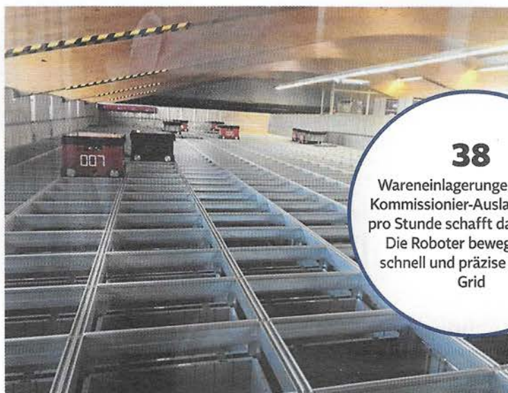
AutoStore-Roboter auf dem Grid: Das Kleinteilelager bei Novopress in Neuss wurde im Mai 2017 erfolgreich in Betrieb genommen. Bild: Hörmann Logistik
