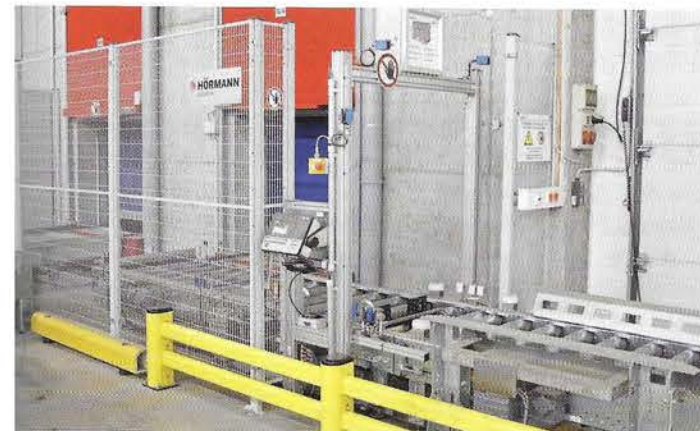
Manueller Palettenaufsatzplatz HRL-Neubau
