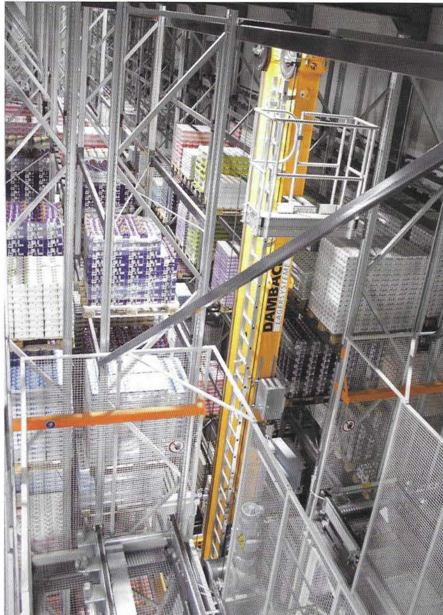
Neue doppeltiefe Gasse in der HRL-Erweiterung
